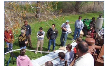
Demostración e instalación llevada a cabo en la cede de Parrat-Wolff, empresa de Servicios de Perforación Ambiental y Geotécnica en Siracusa, New York.
