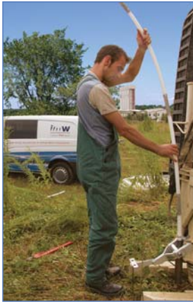
Sistema CMT de 3 canales instalado en Zeitz, Alemania. La instalación se finalizó permitiendo el colapso natural. El sistema monitorea la atenuación natural de BTEX.
